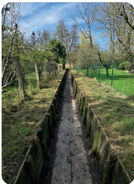
Gestion des eaux pluviales, Janville
